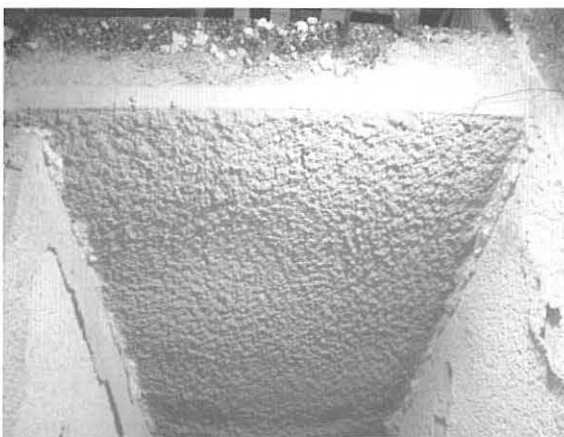
Bild 20: Abplatzungen bzw. Auflösungserscheinungen nach Zwangsbelüftung
