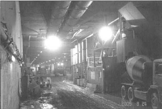
Bild 4: Anlagenkomponenten unter Tage
