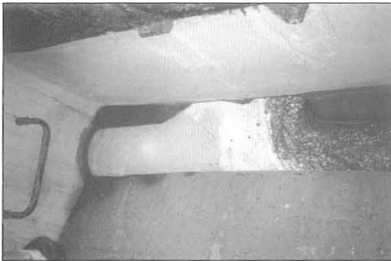
Bild 4: Leitung Ø 250 bei Ulmdrainage-Einleitung zu 80 % verschlossen
