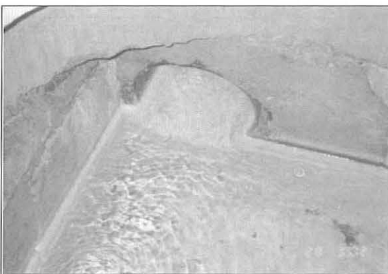
Bild 6: Vollständige Versinterung eines als Pumpensumpf ausgebildeten Putzschafts
