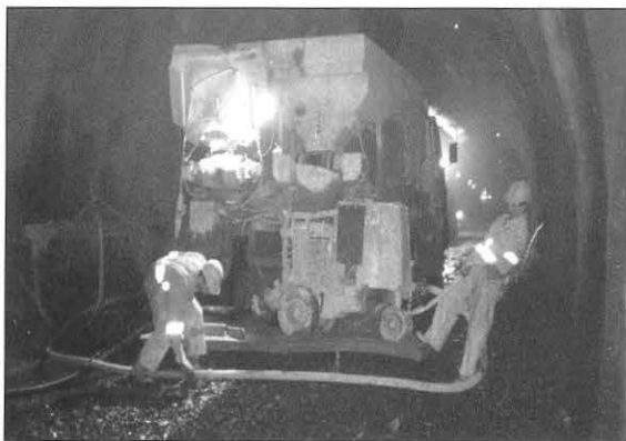
Bild 3: EKS Vomp, Bunkermobil mit Rotormaschine
