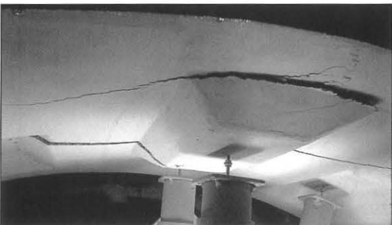
Bild 6: Bruchbereich der imperfekten Schale
