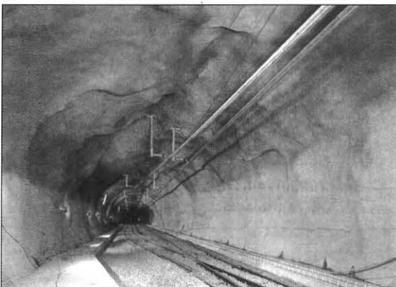
Bild 3: Einschaliger Ausbau mit Spritzbeton im Tunnel der Centovalli-Bahn unter der Stadt Locarno (Foto 1990, H. Germond, Lausanne)
