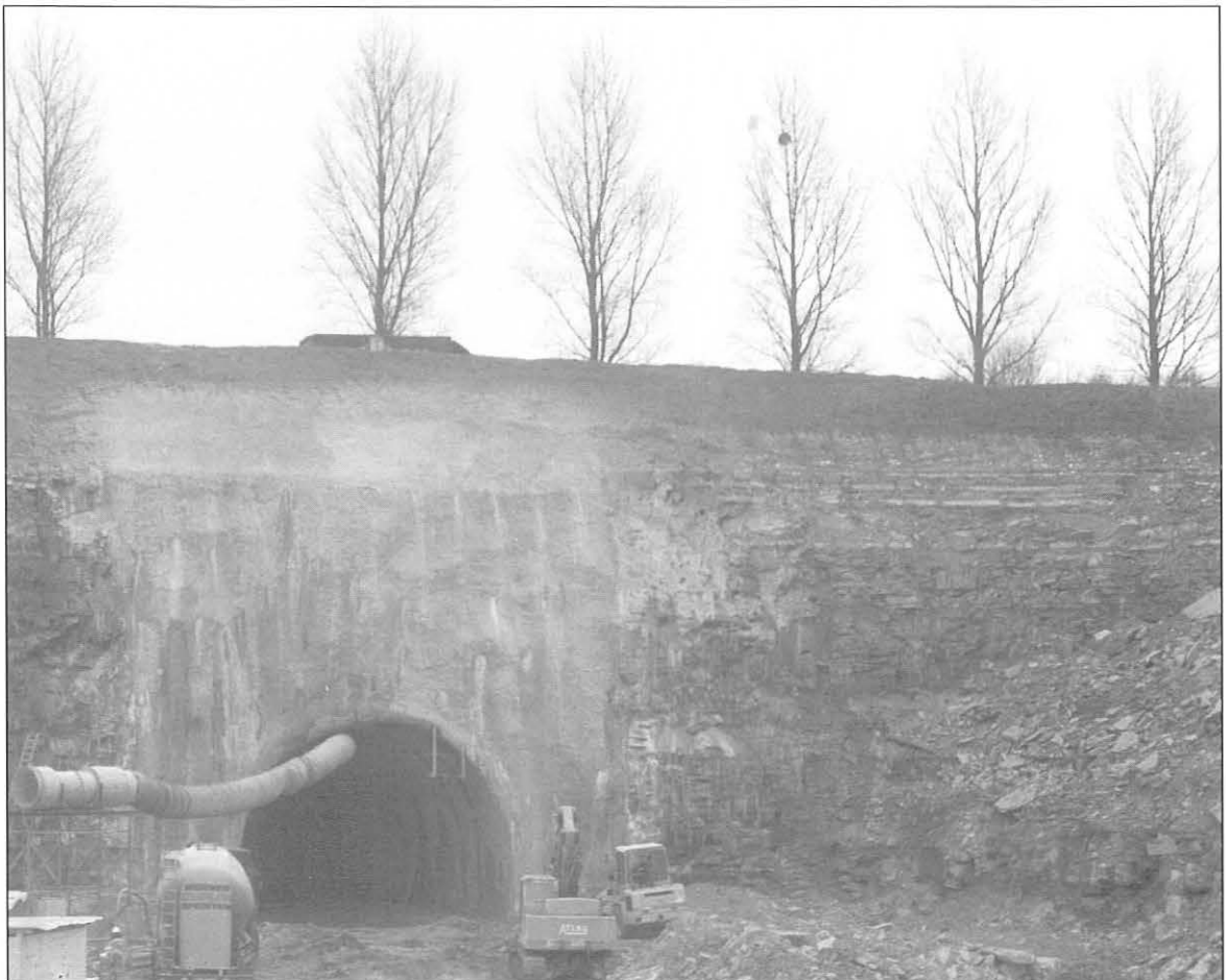
Bild 2: Tunnel unter der B 475 in Neubeckum zur Erschließung eines neuen Abbaugebiets der Dyckerhoff Zement GmbH
