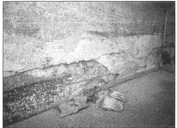
Bild 3: Abplatzungen im Ortbeton
