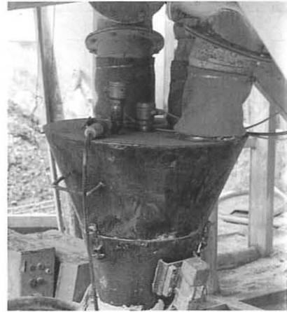
Bild 4: Einlauftrichter zur Spritzmaschine mit Füllstandsonden zur Steuerung der Zuteilschnecken.
