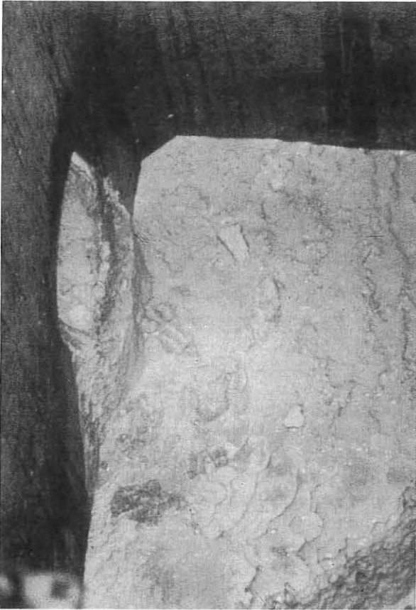
Bild 1: Kalkaussinterungen in einer Tunneldränage
