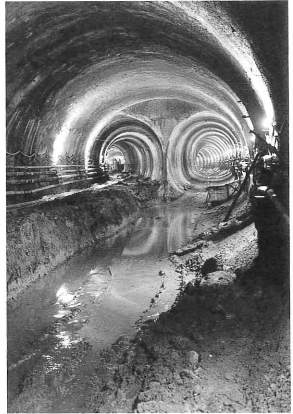
Bild 14: Spritzbetontunnel nach Ablassen der Druckluft
